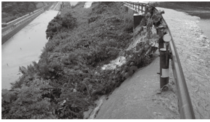
路肩からあふれる豪雨（7月13日駒馳山バイパス）
