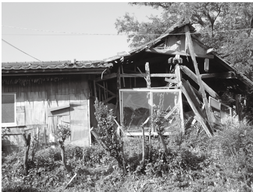
空き家の老朽化が進むと特定空き家に認定される
