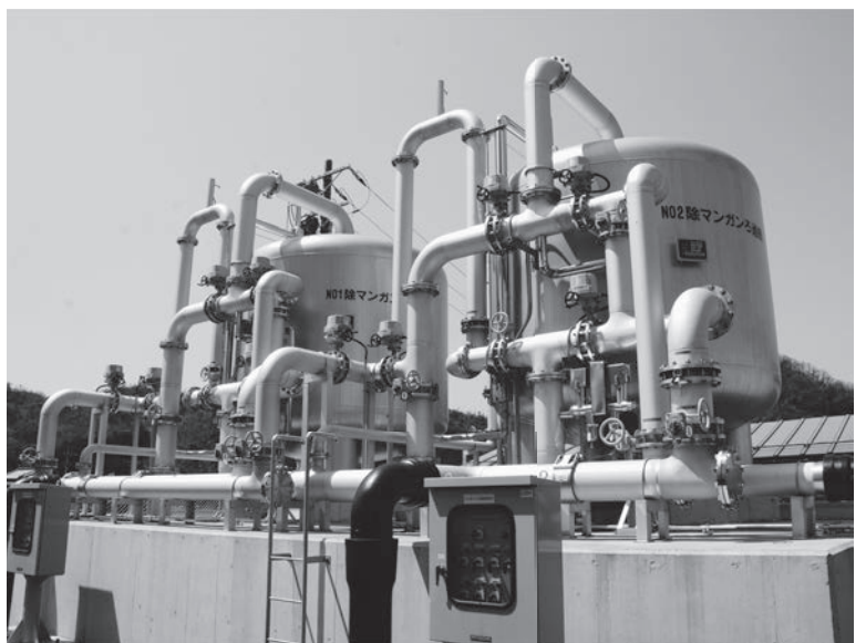
恩志水源マンガンろ過装置
