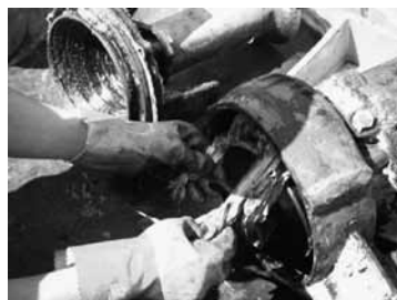
▲マンホールポンプにタオルや下着 が絡まり故障が発生
