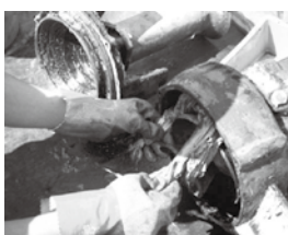
▲マンホールポンプにタオルや下着が絡まり故障が発生。
