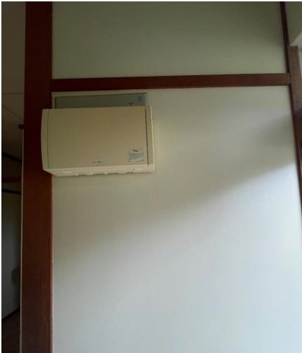
浦富団地 既存分電盤
