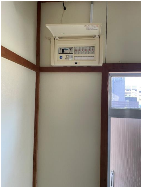
内池田第3団地 既存分電盤
