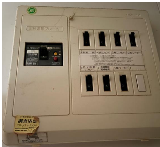
岩本第1団地 既存分電盤 平成5年度建設時からの製品
