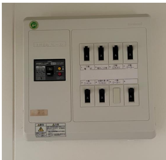
岩本第2団地 既存分電盤 平成7年度建設時からの製品
