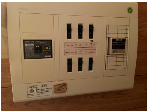
下坪井団地 既存分電盤 平成11年度建設時からの製品
