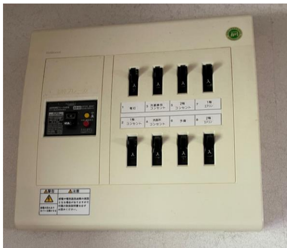
岩本第3団地 既存分電盤 平成8年度建設時からの製品
