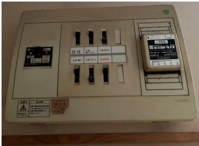
横丁第2団地 既存分電盤 平成12年度 建設時からの製品
