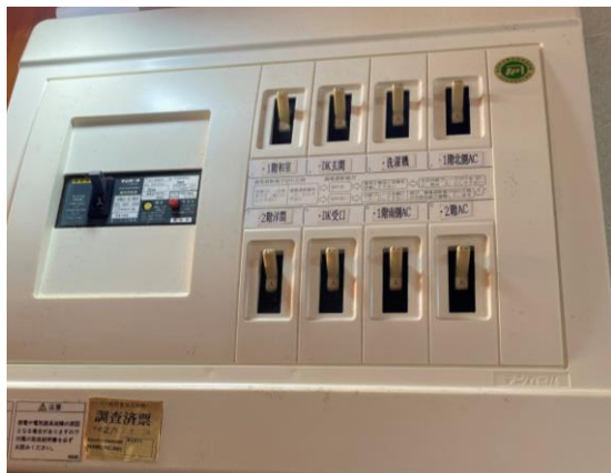
大谷団地 C棟 既存分電盤 平成10年度 建設時からの製品 3,4,7,8,9,10,21,22,29,30,39,40号
