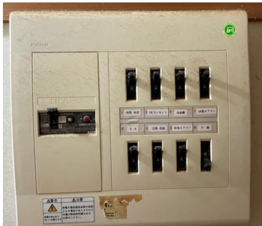
大谷団地 A棟 既存分電盤 平成10年度 建設時からの製品 19,20号
