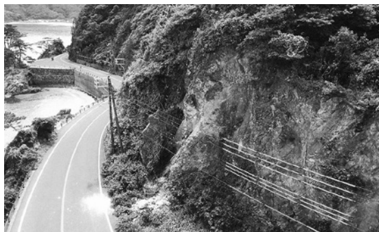
早期開通が望まれる町道陸上中央線（落石箇所）
