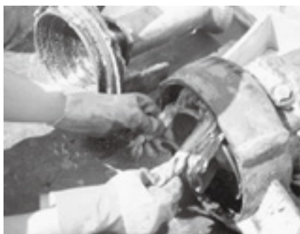
【タオルがマンホールポンプに絡みつき故障が発生！】
